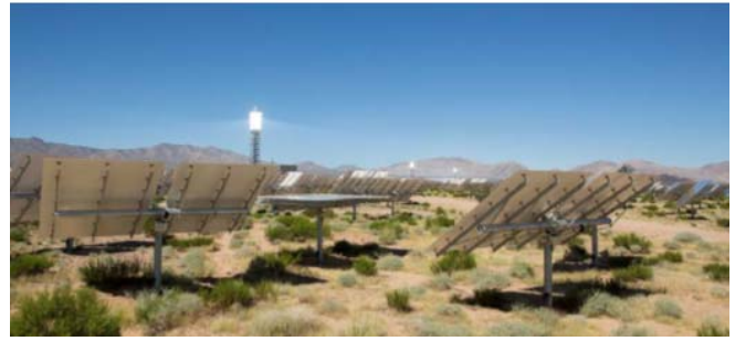
Fig. 5 LH-2.2 heliostats at Ivanpah
